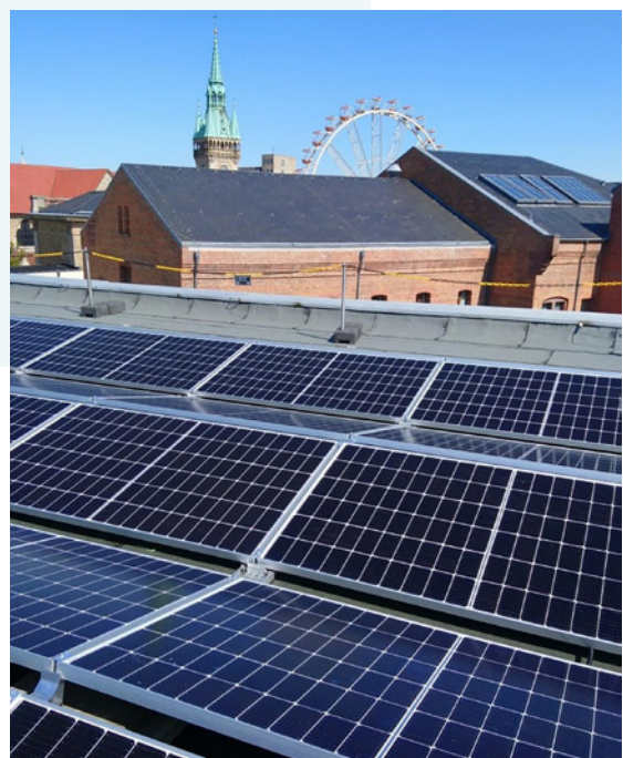
PV-Anlage Gymnasium Kleine Burg, Braunschweig.
