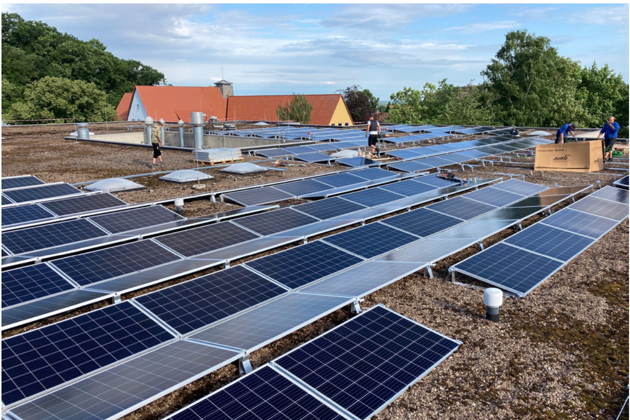
Photovoltaik-Anlage auf dem Dach der IGS Obernkirchen © Landkreis Schaumburg, Nils Althoff.
