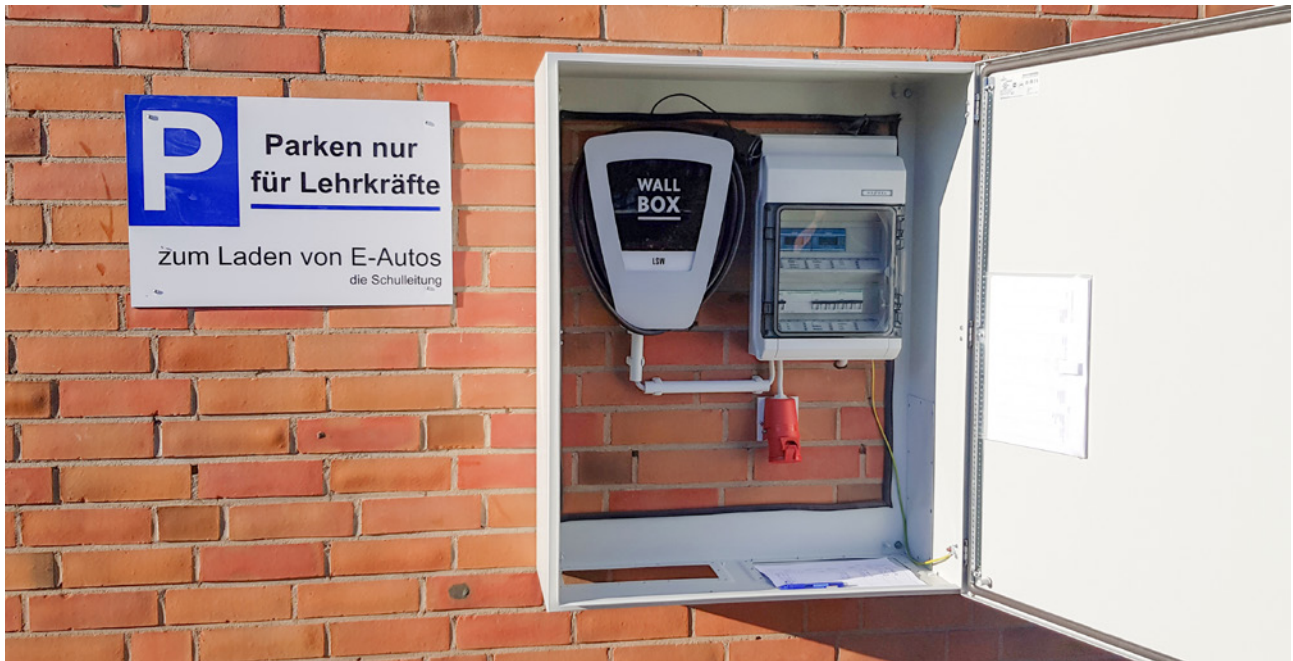
Beitrag zur CO 2 -Reduzierung: Aufstellen von E-Ladesäulen auf dem Lehrkräfteparkplatz. © Martin Vollrath, Sibylla-Merian-Gymnasium Meinersen.
