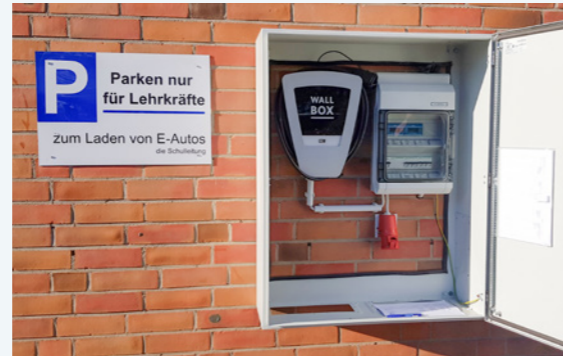
Ladesäule auf Lehrerparkplatz des Sibylla-Merian-Gymnasiums
