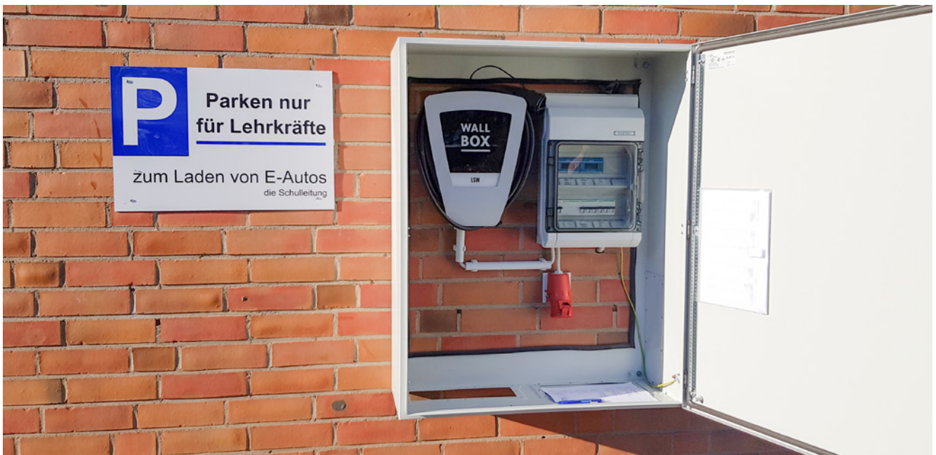
Beitrag zur CO 2 -Reduzierung: Aufstellen von E-Ladesäulen auf dem Lehrkräfteparkplatz. © Martin Vollrath, Sibylla-Merian-Gymnasium Meinersen.
